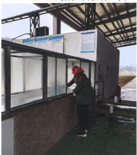
DW001 废水总排放口
