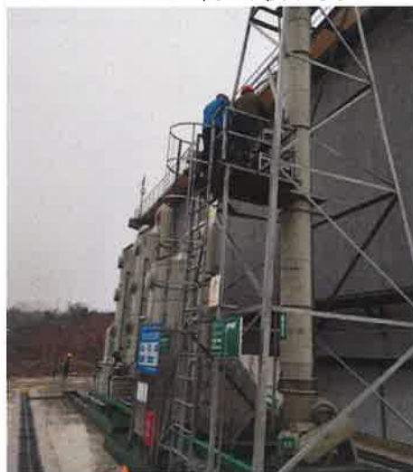
DA017 刚性填埋场废气排放口
