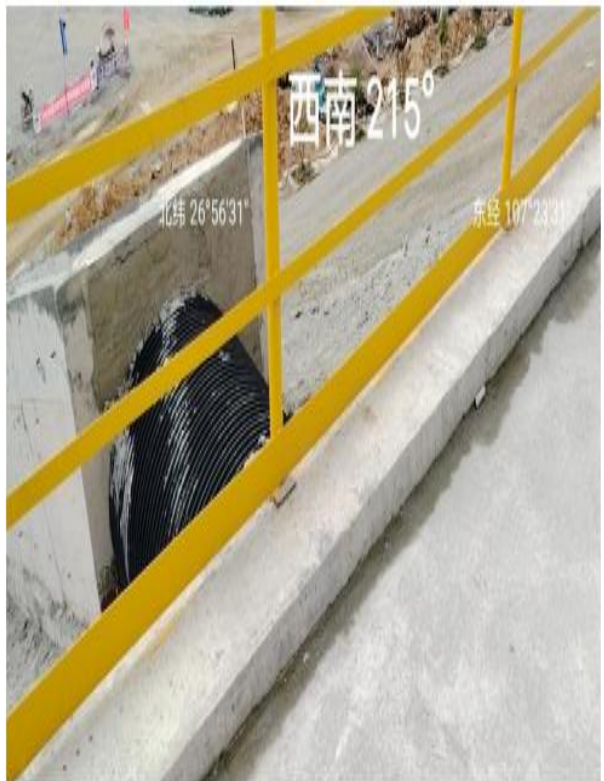
矿石堆场挡墙排水波纹管（ \phi 1200mm）
