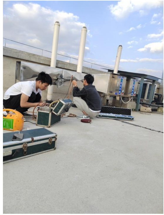
FQ1 油烟净化器排放口
