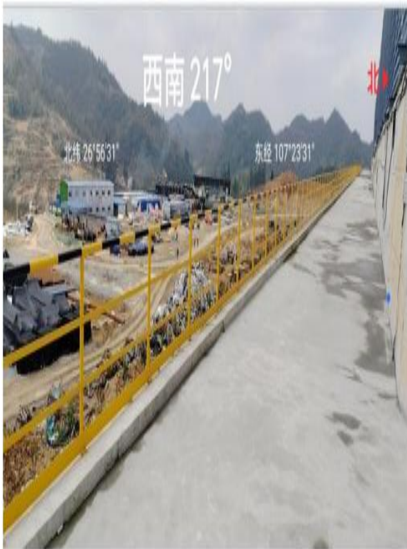
矿石堆场设置的截水沟
