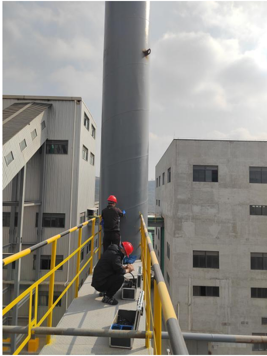
F1 破碎筛分车间排口
