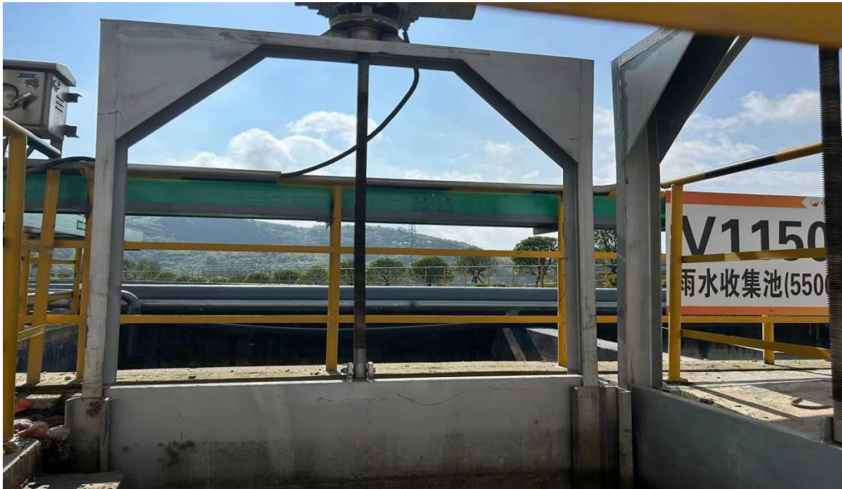
图4-6 初期雨水池切换阀
