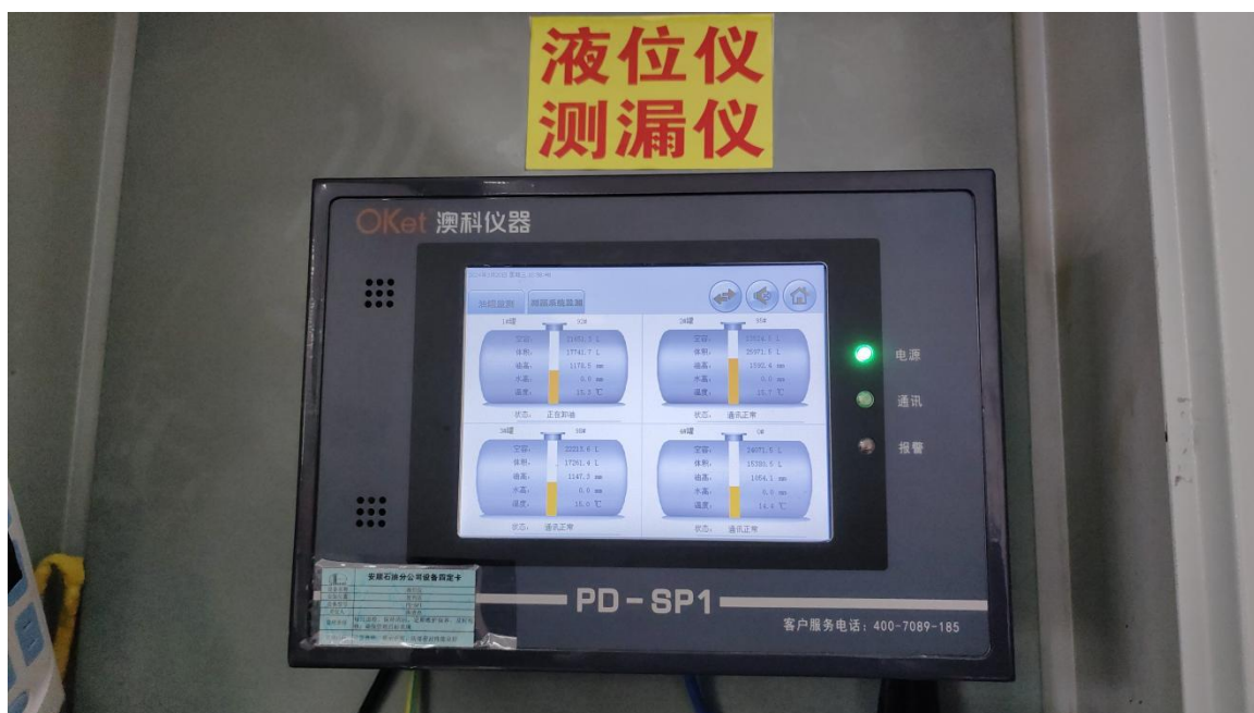
液位仪、渗漏检测一（一体显示器）
