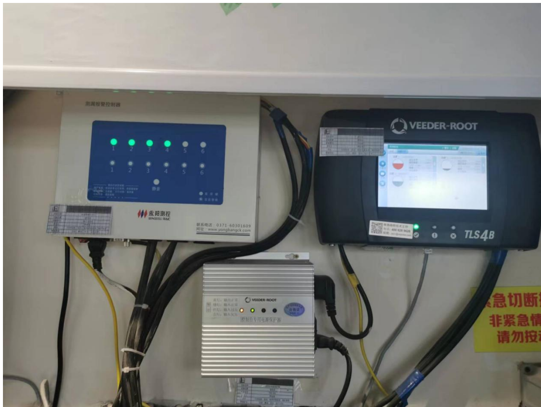
液位仪、渗漏检测仪
