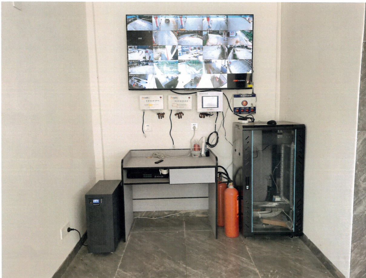
监控系统、渗漏监测系统、液位仪等
