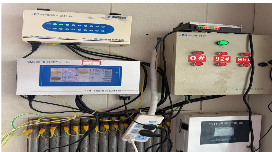
液位仪、渗漏检测仪、控制柜、可燃气体报警控制柜
