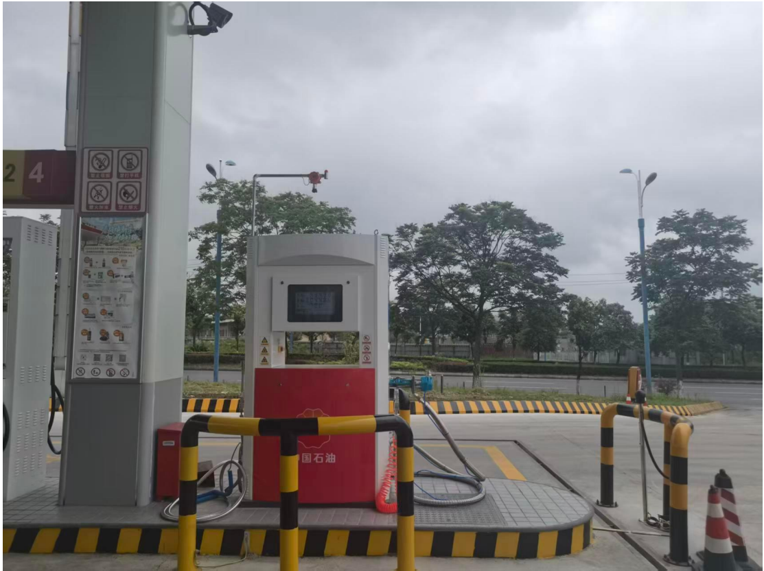
加气机及加气机旁的可燃气体检测报警装置
