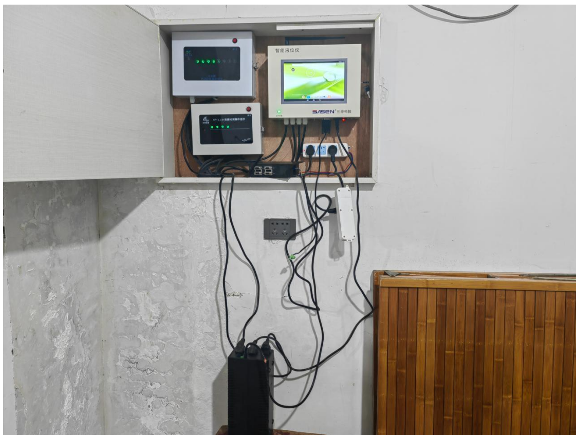
液位仪、渗漏检测仪、UPS 电源
