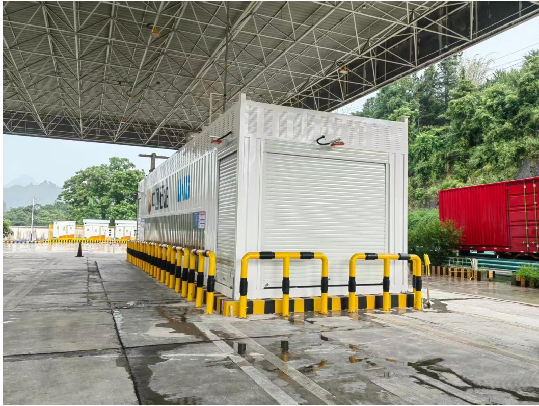
LNG 撬装装置全景
