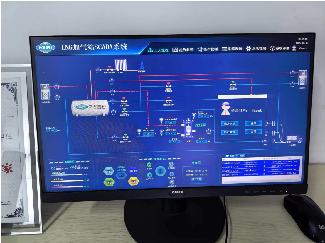
LNG 加气站 SCADA 系统
